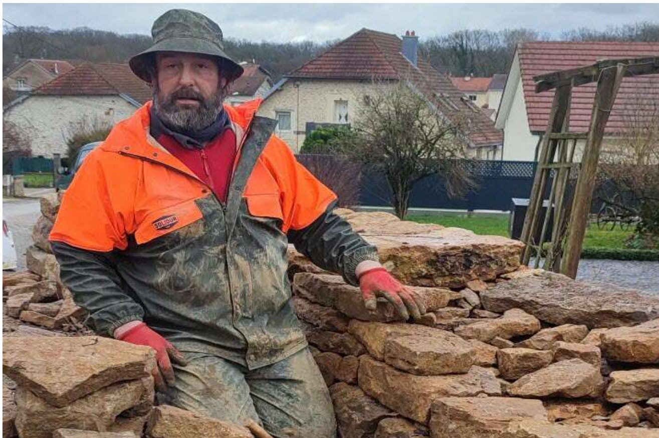
Stéphane Jutzi était intervenu il y a plusieurs semaines sur la restauration d'un mur en pierre sèche, dans la commune de Franois. L'Est Républicain – 07 janv. 2024
